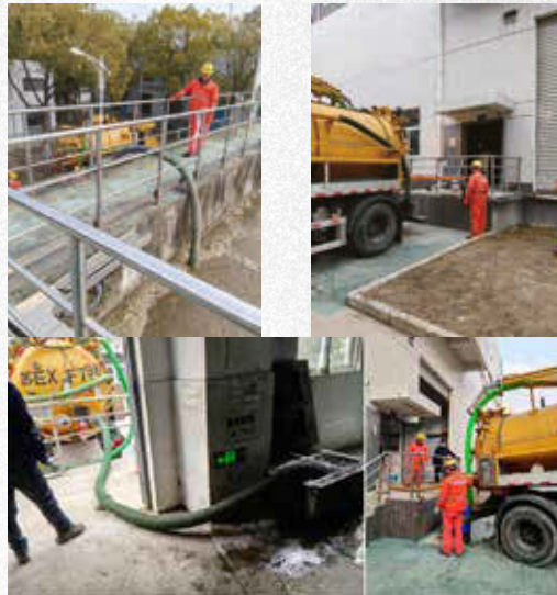
污水處理設施
