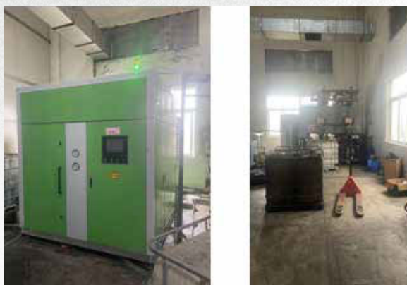
油水分離設施
