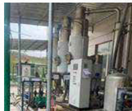
MAO廢藥劑蒸餾設備
